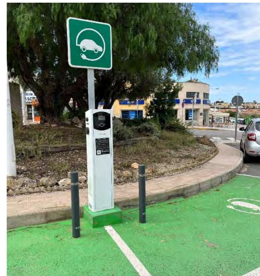
Ilustración 126. Punto de recarga para vehículo eléctrico en Gran Alacant en Santa Pola. Fotografía propia
