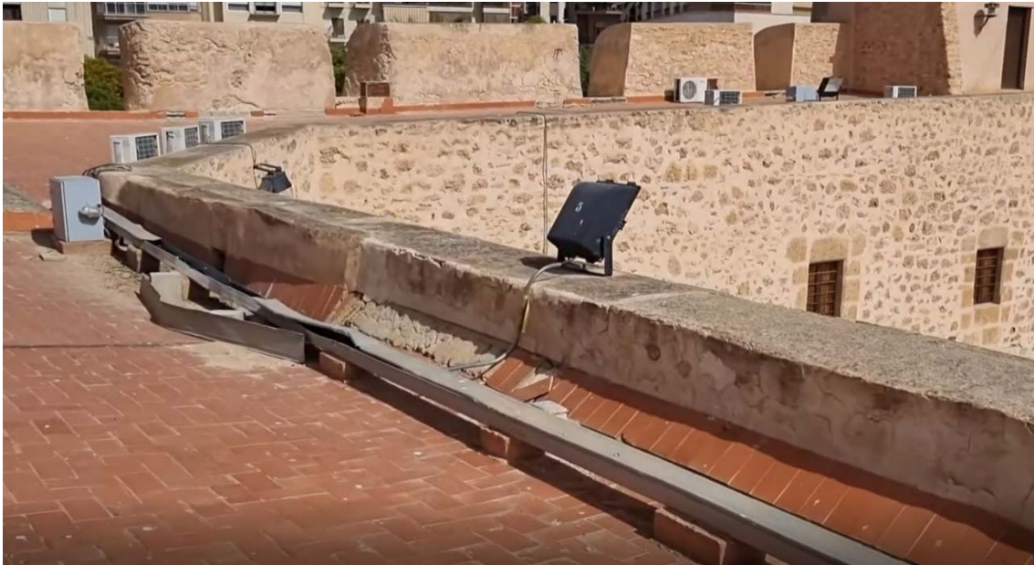
Instalaciones y enfoscados impropios, roturas en el mimbel
