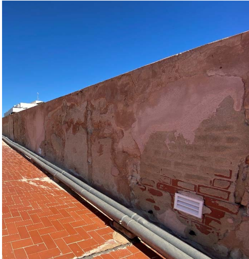
Almenas tapiadas con ladrillo y revestimiento impropio
