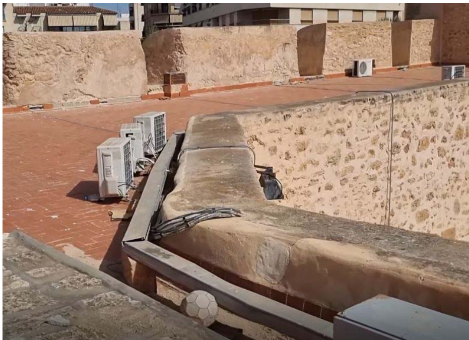
Instalaciones en la cubierta
