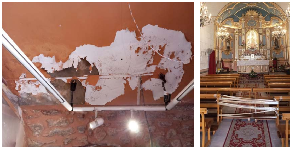
Desperfectos por humedades e inhabilitación de espacios por filtración de agua
