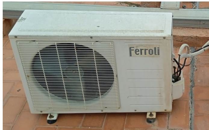
Tuberías de refrigerante con tramos no aislados
