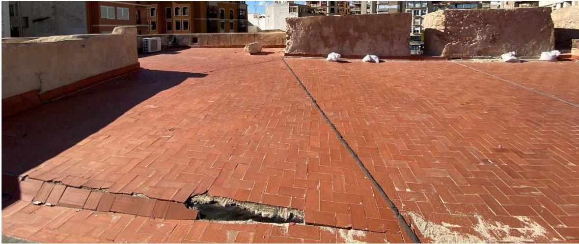
Roturas en el pavimento, juntas de dilatación en mal estado
