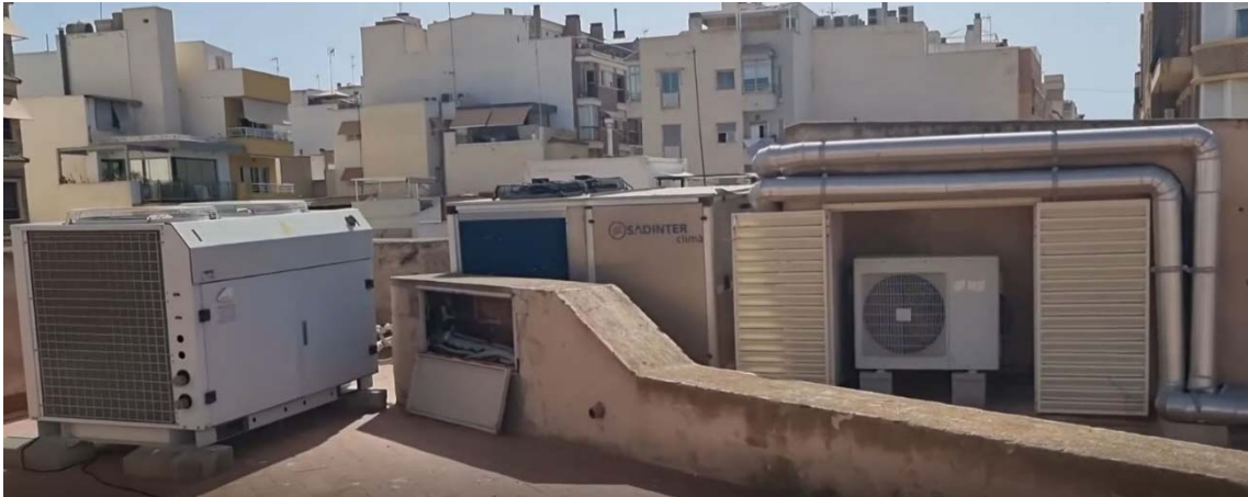
Equipos de A/A sin funcionamiento
