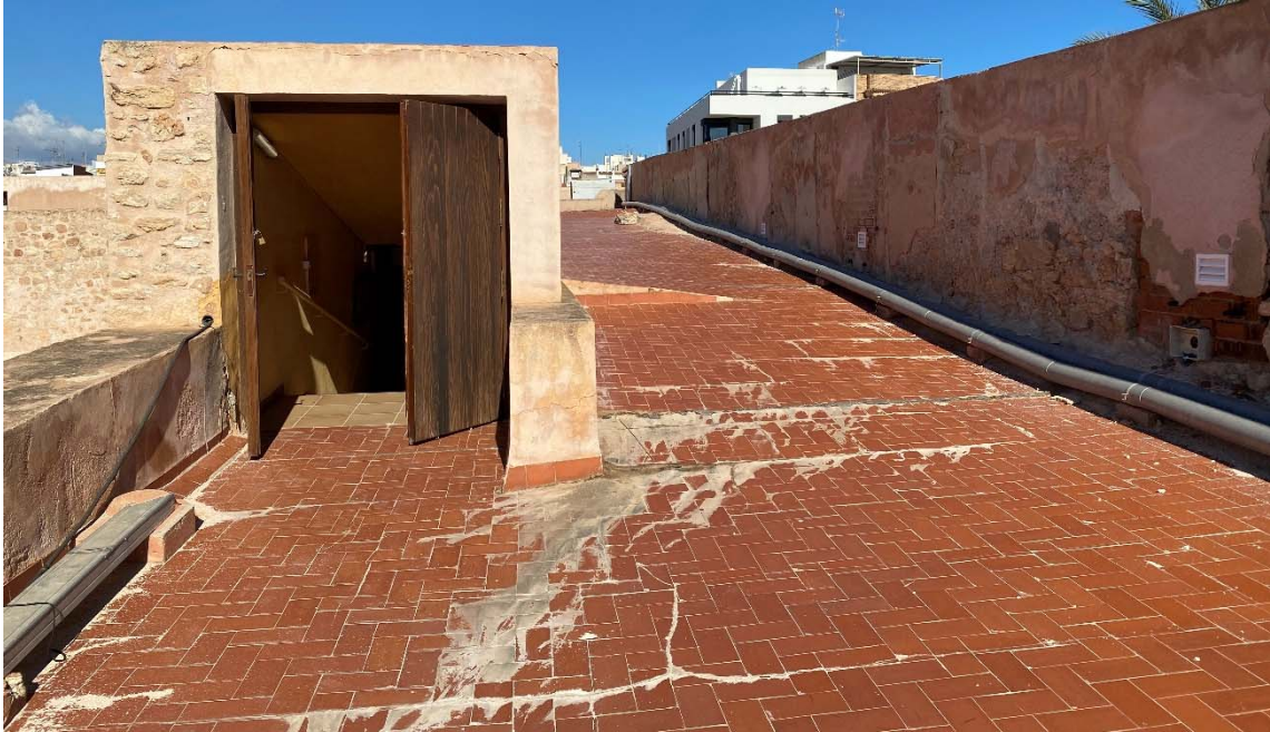
Deterioro del pavimento
