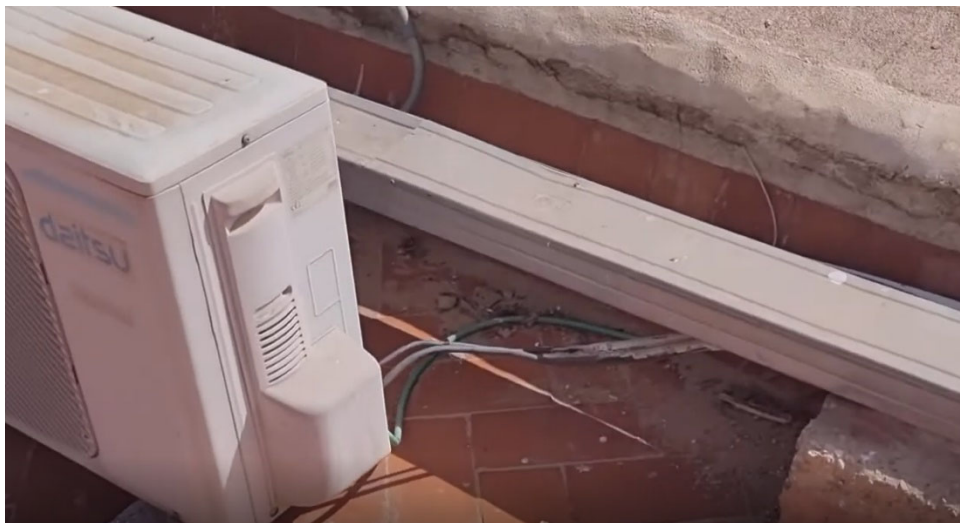
Tuberías de refrigerante con aislamiento deteriorado por el sol.
