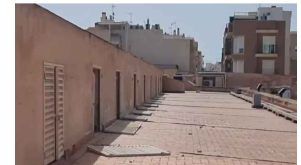
D03_ Armarios existente para unidades exteriores
