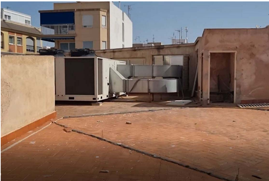
Equipos de A/A, armarios para unidades exteriores, juntas de dilatación en mal estado
