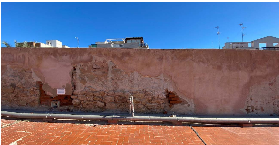
Deterioro de tapiados
