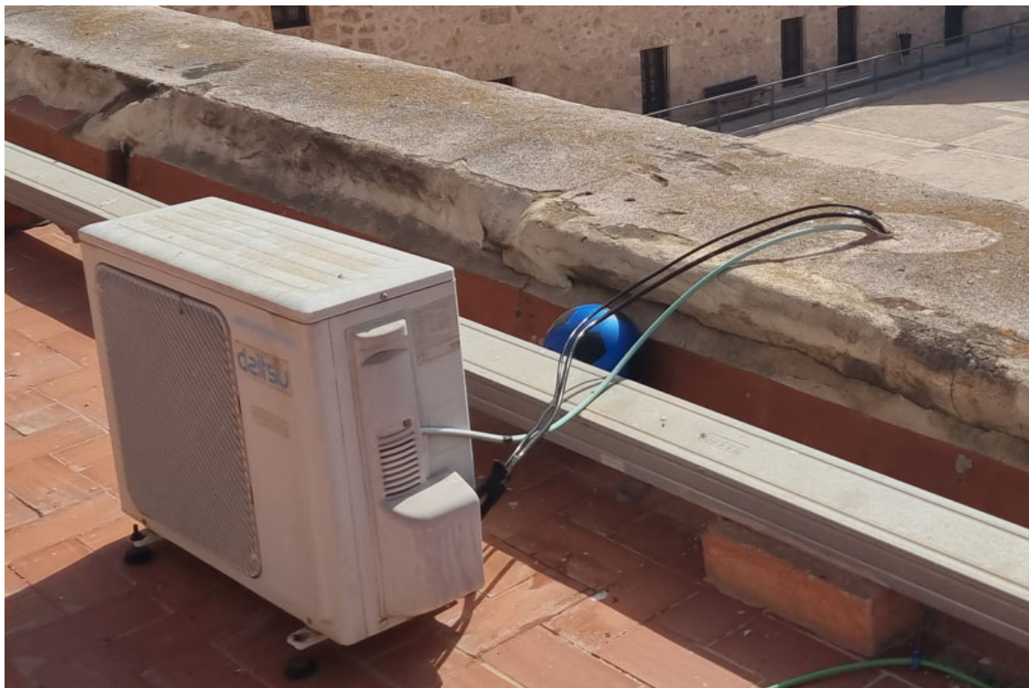
Tuberías de refrigerante sin asilamiento deteriorado por el sol.
