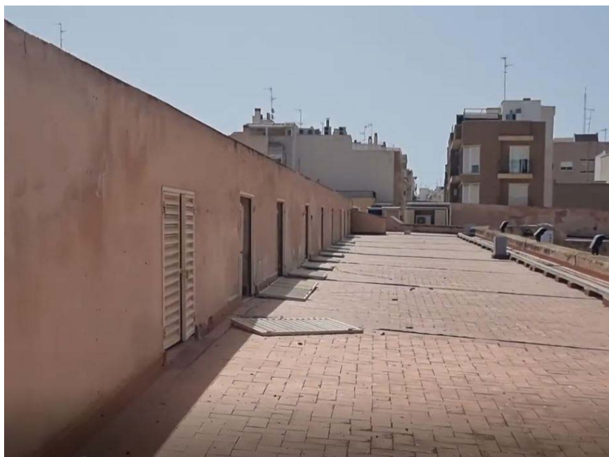
Puertas de los armarios de las unidades exteriores de A/A en el suelo
