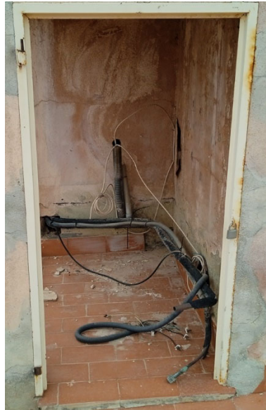
Tuberías sin uso. Foto 610
