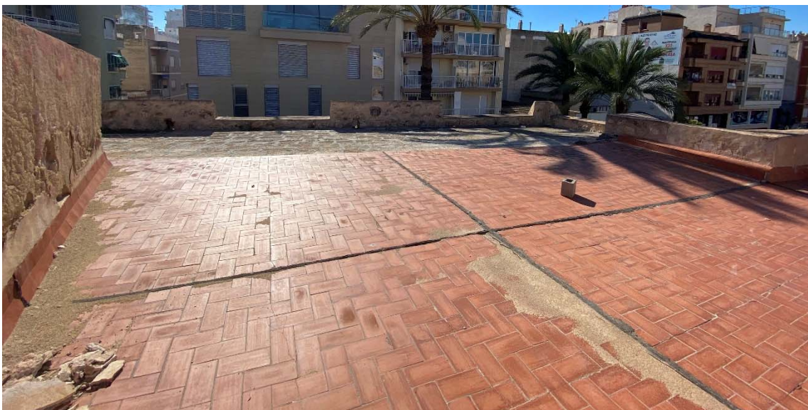
Roturas en el pavimento, juntas de dilatación en mal estado, restos del revestimiento de almenas
