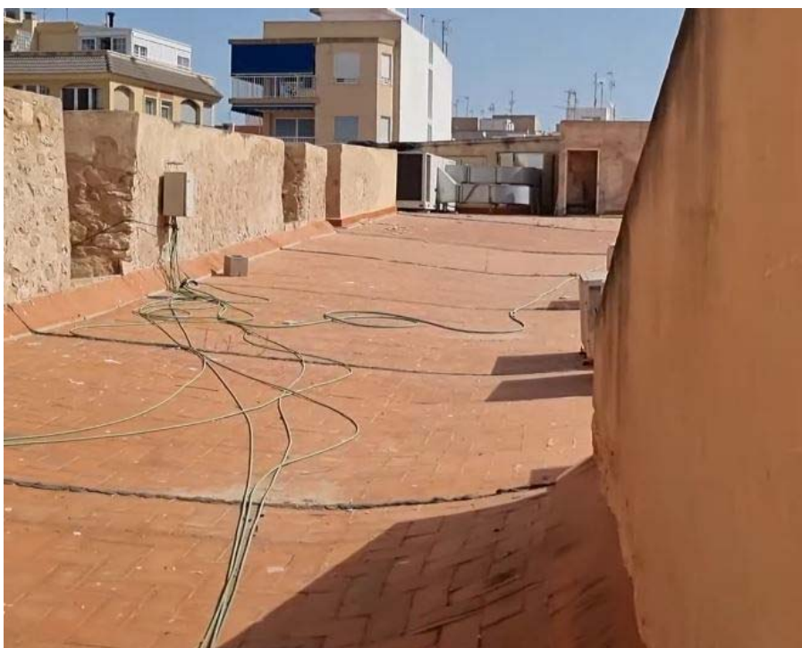
Instalaciones en la cubierta
