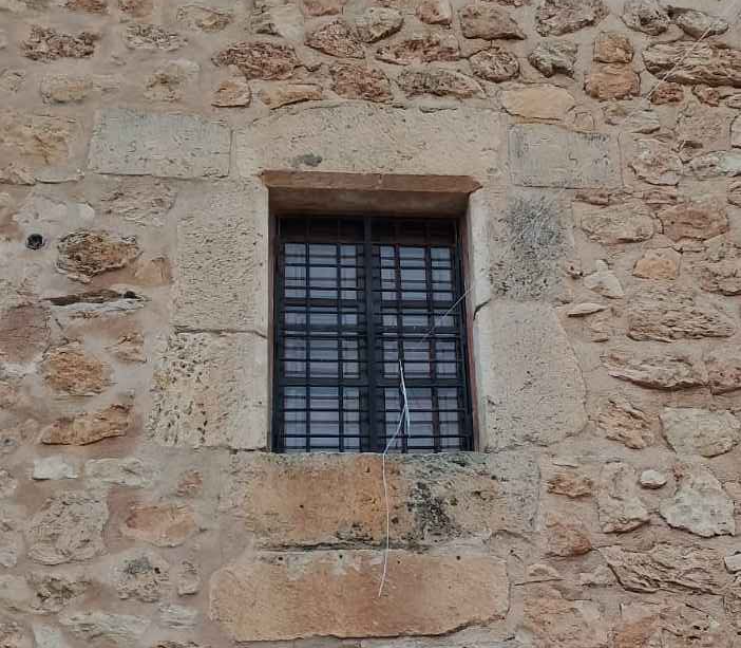
Imágen cerrajería existente
