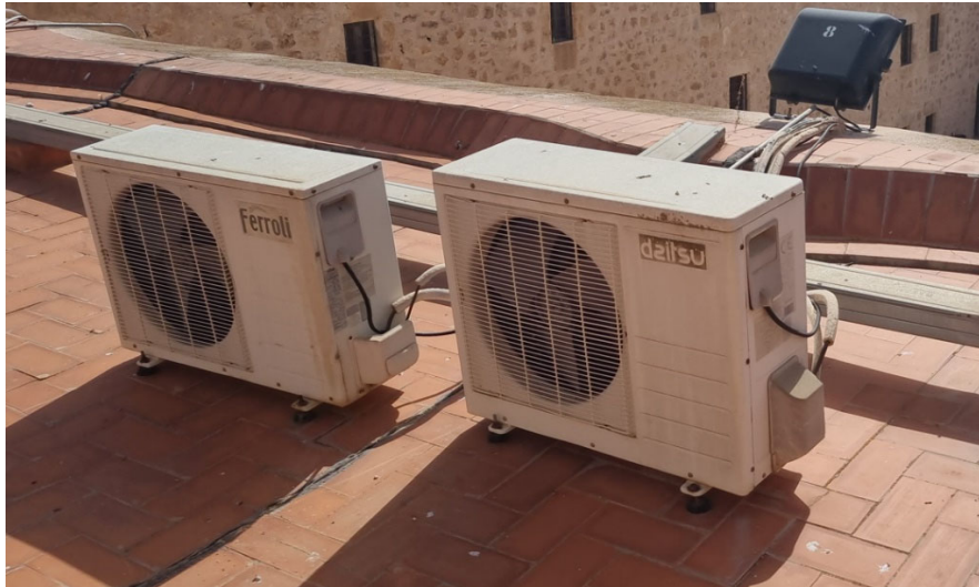
Una unidad exterior para Split Ferrolli cerca del patio de armas.
